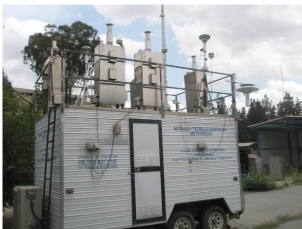
Εικόνα 7.2: Ο σταθμός στην περιοχή κυκλοφοριακής κίνησης στη Λευκωσία
