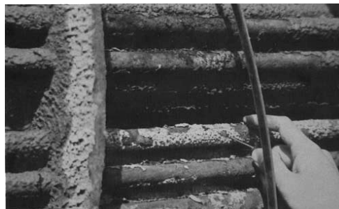
Εικόνα 1.4: Εναλλάκτης Θερμότητας με ανόργανες επικαθίσεις και προϊόντα διάβρωσης.
