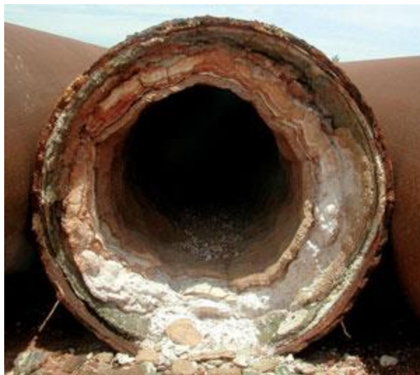
Εικόνα 3: Διάβρωση μεταλλικών επιφανειών σε σωληνώσεις.
