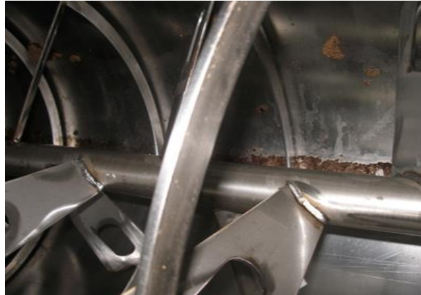
Εικόνα 18: Εσωτερικός χώρος μαλακτήρα
