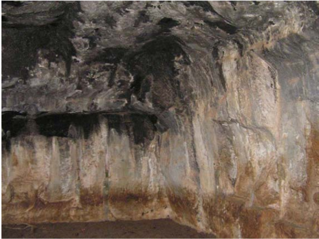
Εικ. P200: Ελεύθερνα, Περιστερές. Χώρος Β. Η εκσκαφή του ορύγματος άρχισε από την οροφή του λατομείου (βλ. άνω τμήμα φωτογραφίας).
