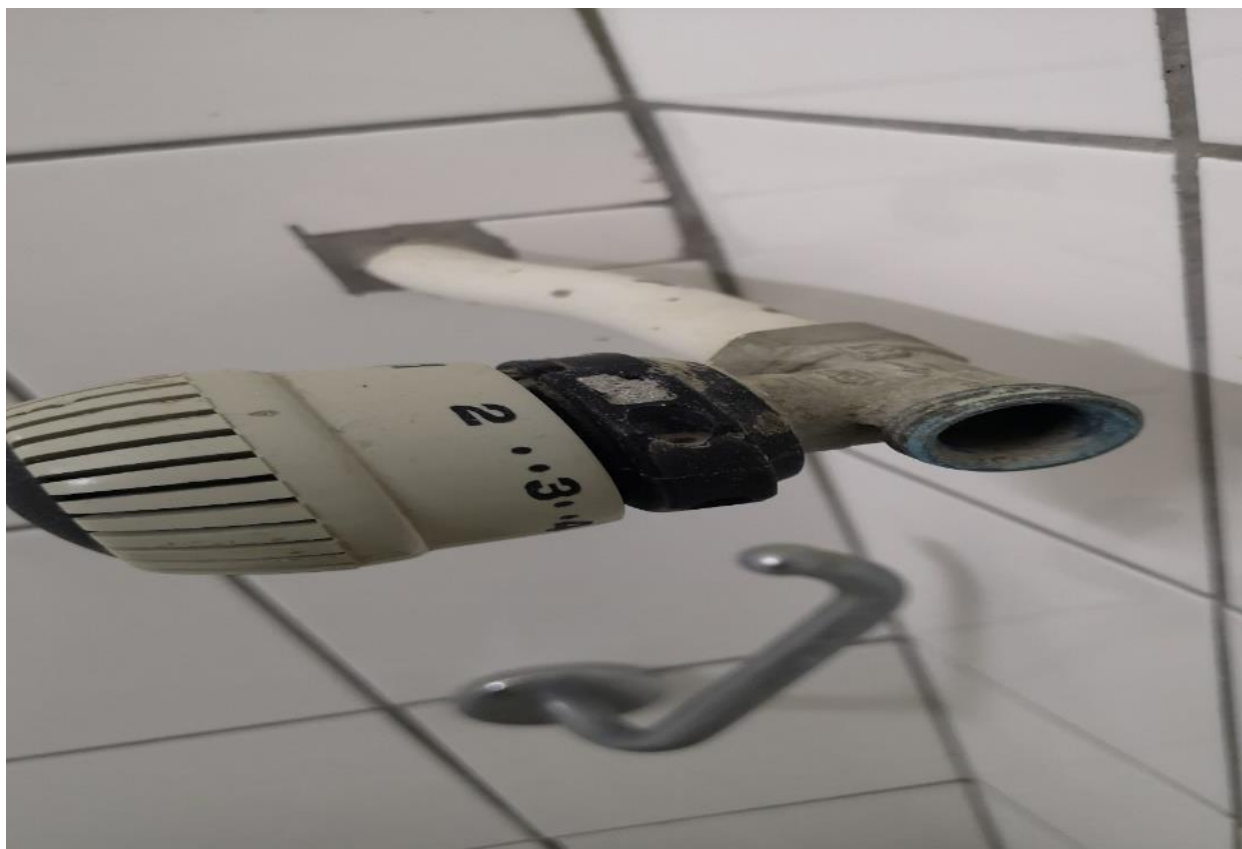
Εικόνα 5: Σωλήνας τροφοδοσίας συσκευής θέρμανσης νοσηλευτικού ιδρύματος που δεν λειτουργεί, δημιουργώντας «τυφλό σημείο».
