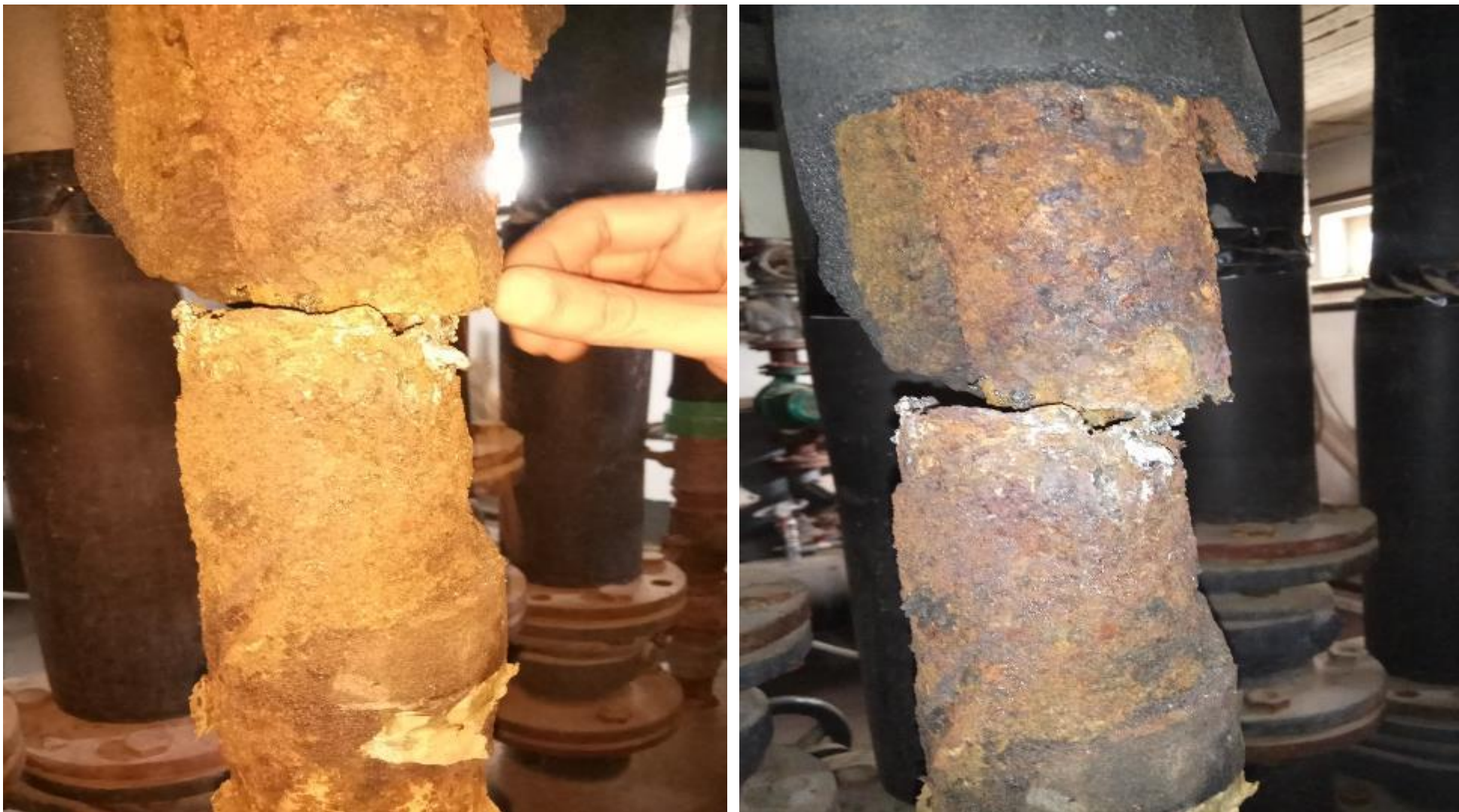
Εικόνα 46: Οξειδωμένες και καταστραμμένες σωλήνες διανομής ζεστού νερού που είχαν μόλις αντικατασταθεί εξαιτίας της διαρροής
