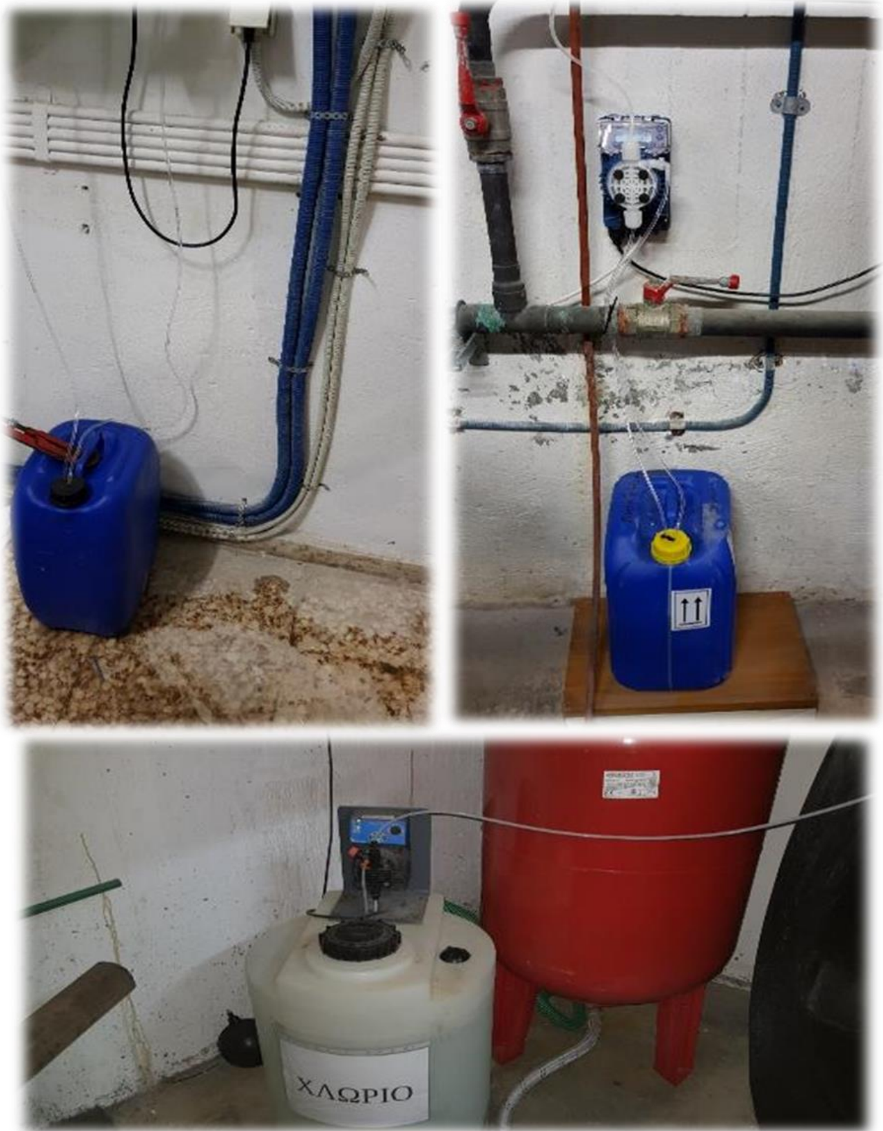
Εικόνα 29: Πρόχειρα συστήματα χλωρίωσης του νερού δικτύου ξενοδοχειακών μονάδων
