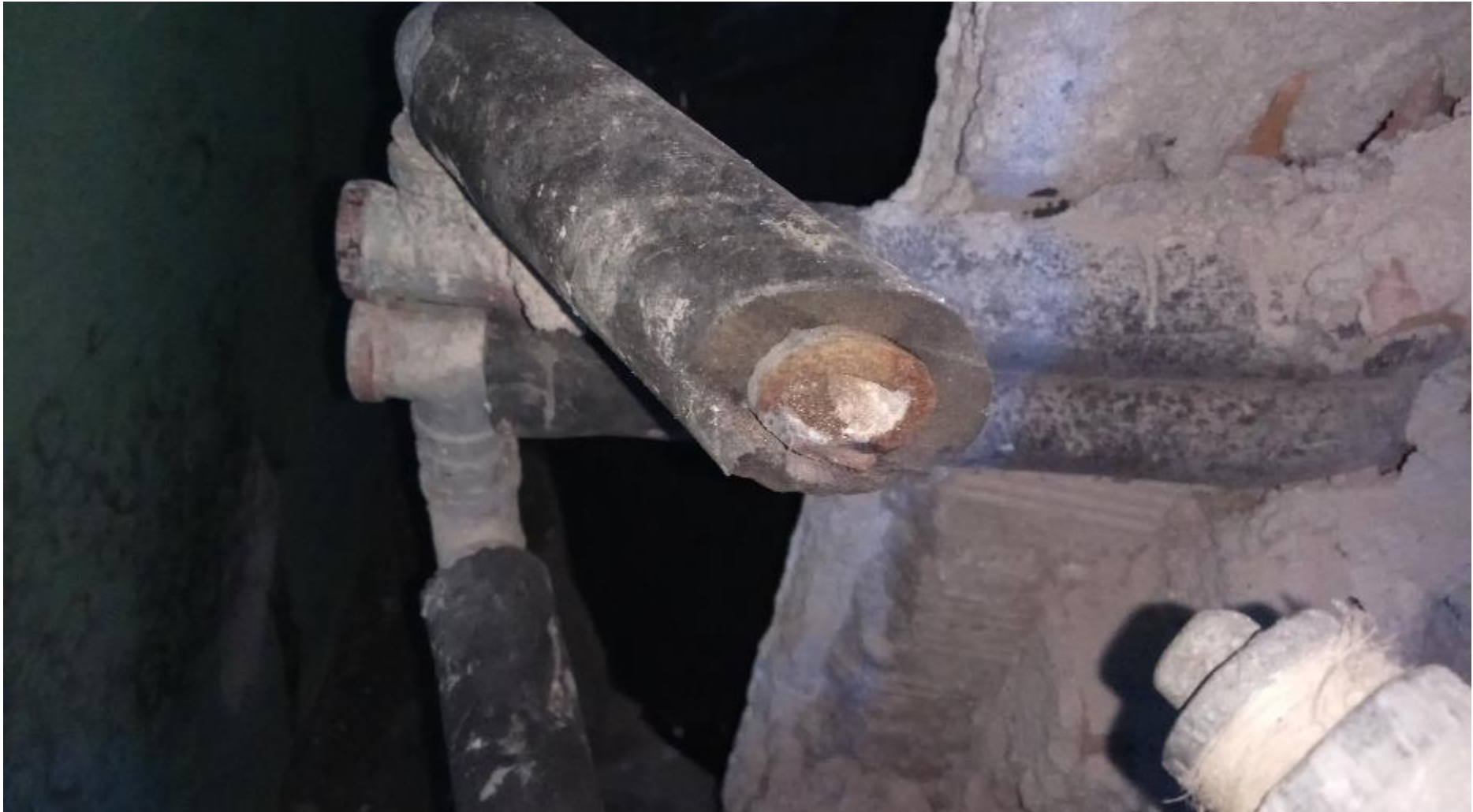
Εικόνα 45: Ανόργανες εναποθέσεις σε ορισμένους από τους σωλήνες του συστήματος νερού.
