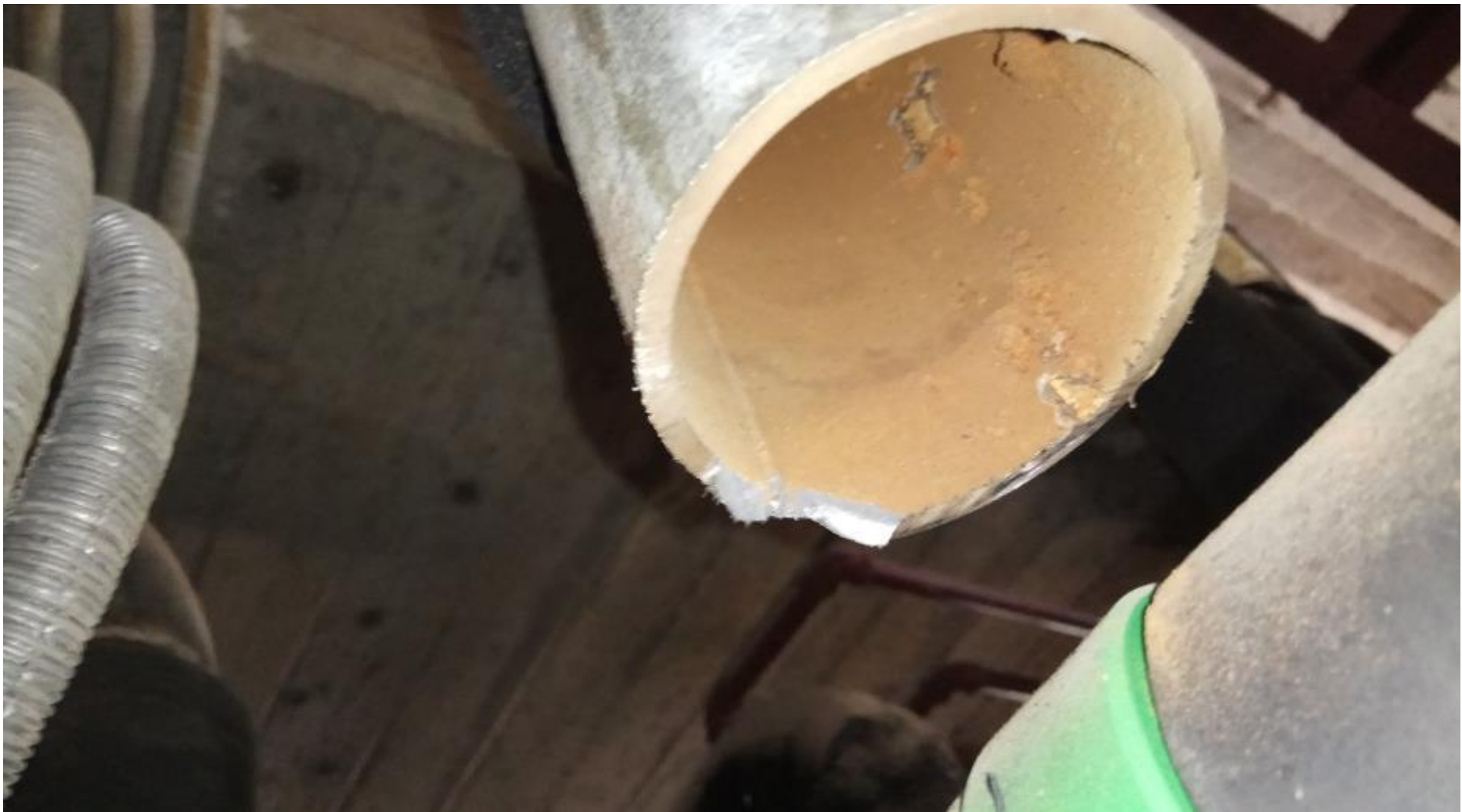
Εικόνα 47: Διατομή σωλήνα από το δίκτυο ύδρευσης με εμφανή σημάδια οργανικών και ανόργανων στρωμάτων στο εσωτερικό της
