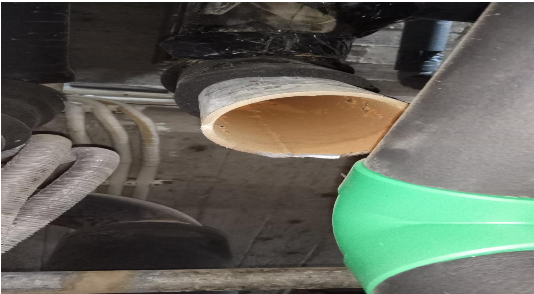
Εικόνα 44: Διατομή σωλήνα από το δίκτυο ύδρευσης με εμφανή σημάδια οργανικών και ανόργανων στρωμάτων στο εσωτερικό της και παρά το γεγονός ότι είχε πρόσφατα αντικατασταθεί
