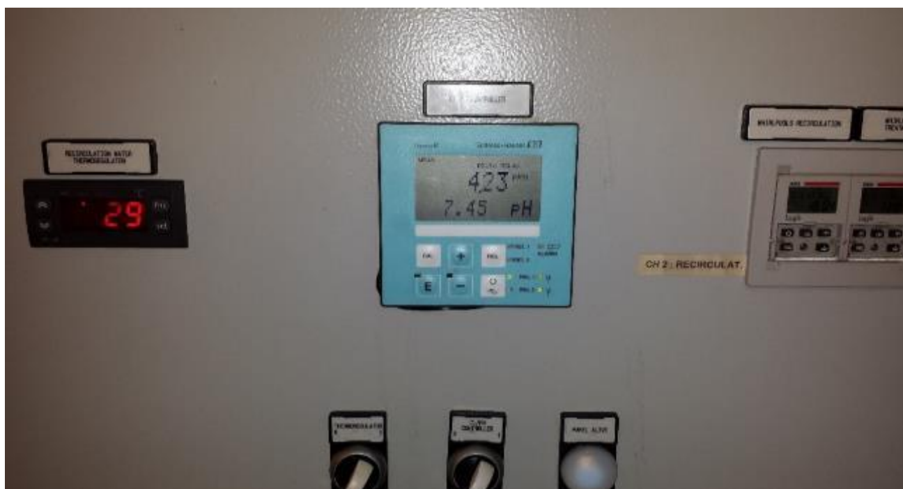
Εικόνα 22: Ηλεκτρονική παρακολούθηση και καταγραφή χλωρίωσης
