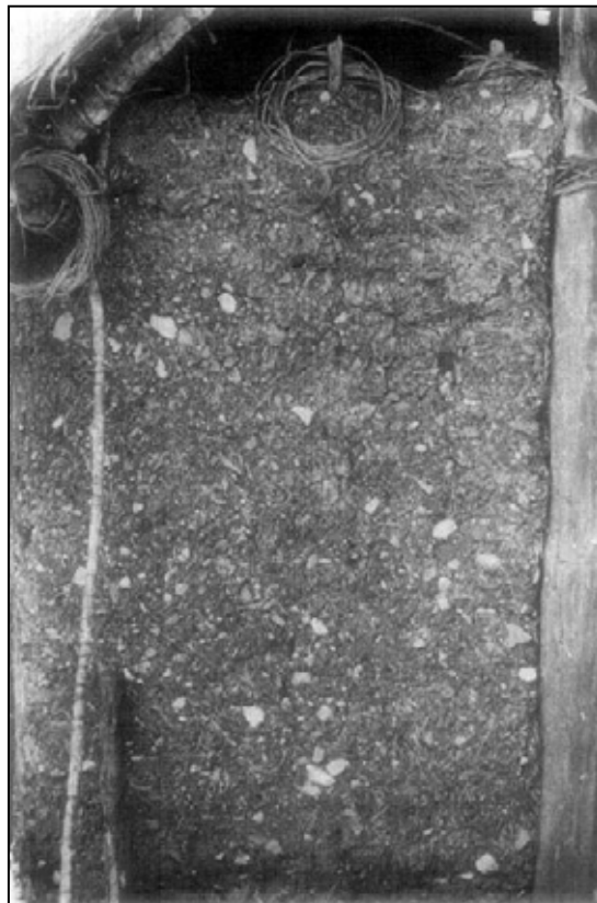
Εικόνα 93. Καλαμωτή κατασκευή στο Aguacatenango. Για τη λάσπη μεταξύ των άλλων έχουν χρησιμοποιηθεί και όστρακα μικρού μεγέθους (Deal 1985, 266, εικ.15).
