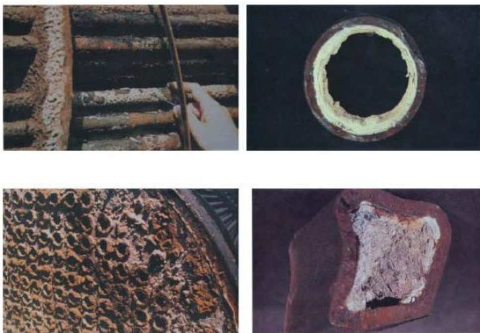
Εικόνα 1.19: Παραδείγματα εναπόθεσης αλάτων και διάβρωσης σε υδατικά βιομηχανικά συστήματα. Ελήφθη από την παραπομπή 57.
