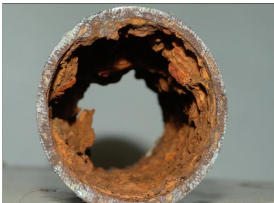
Εικόνα 10 Διάβρωση μεταλλικής επιφάνειας σωλήνα.
