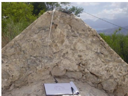
Εικ. 6. Κάτω Άη Γιώργης Κρούστα. Το σηθαιό της ανατολικής πλευράς του ναού.
