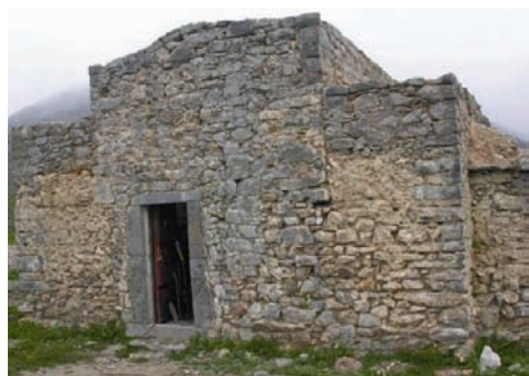
Εικ. 11. Ναός Αγίου Πνεύματος στο Λιμνάκαρο. Η νότια όψη του ναού μετά τις καθαυρέσεις των επιχρισμάτων. Διακρίνονται οι ραφές στην τοικοποιία που τεκμηριώνουν την ανύψωση του ναού.
