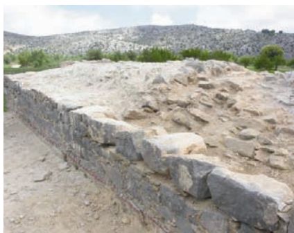
Εικ. 13. Ναός Αγίου Πνεύματος στο Λιμνάκαρο. Ο εγκάρσιος θόλος του ναού κατασκευασμένος σε δύο φάσεις.
