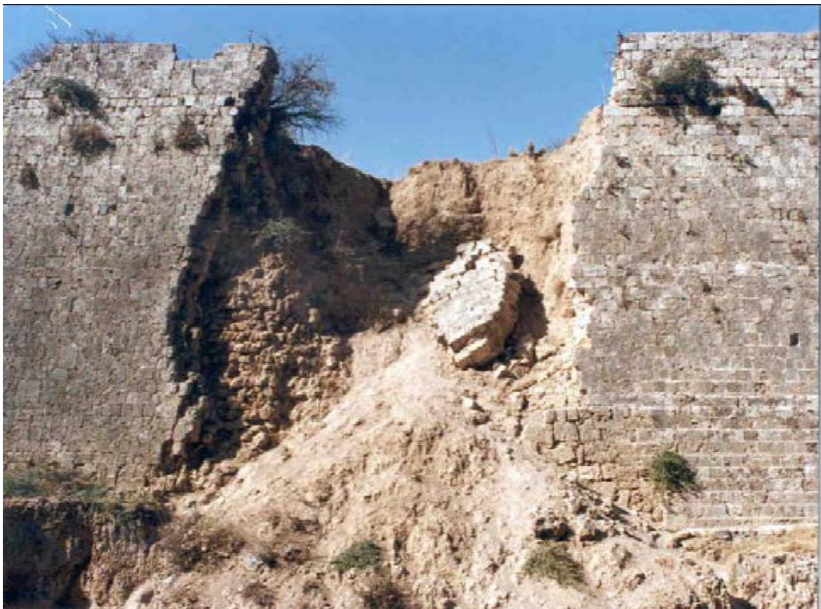
Εικόνα 3.12: Αποσάθρωση Κονιαμάτων, Μεσαιωνική Πόλη της Ρόδου
