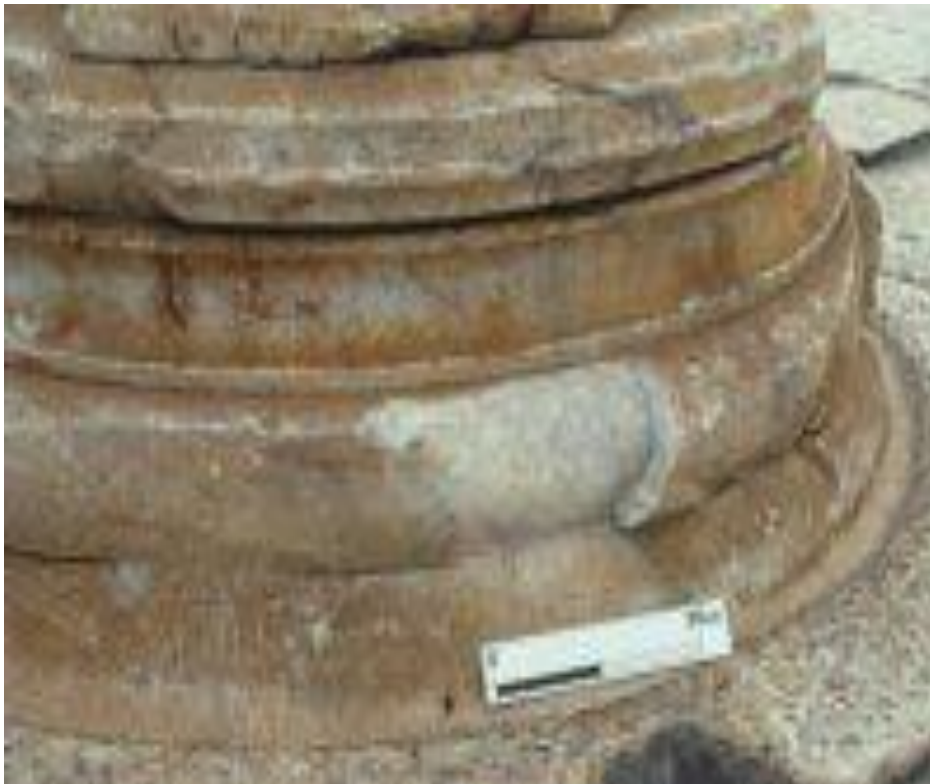
Εικόνα 3.20: Μικροβιακή προσβολή μνημείου, με αποτέλεσμα την αποκόλληση τμήματος αυτού
