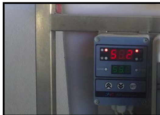
Εικόνα 6.17: Επιθυμητή Θερμοκρασία 55°C.
