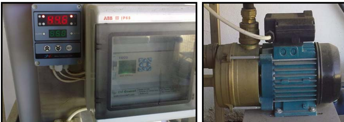
Εικόνα 6.3: Ηλεκτρικός Πίνακας Αυτοματισμού και Αντλία.
