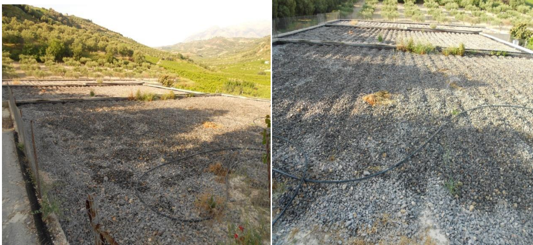
Εικόνα 2.3: Βιολογικά φίλτρα στην εγκατάσταση επεξεργασίας λυμάτων Σταυρακίων- Βουτών.
