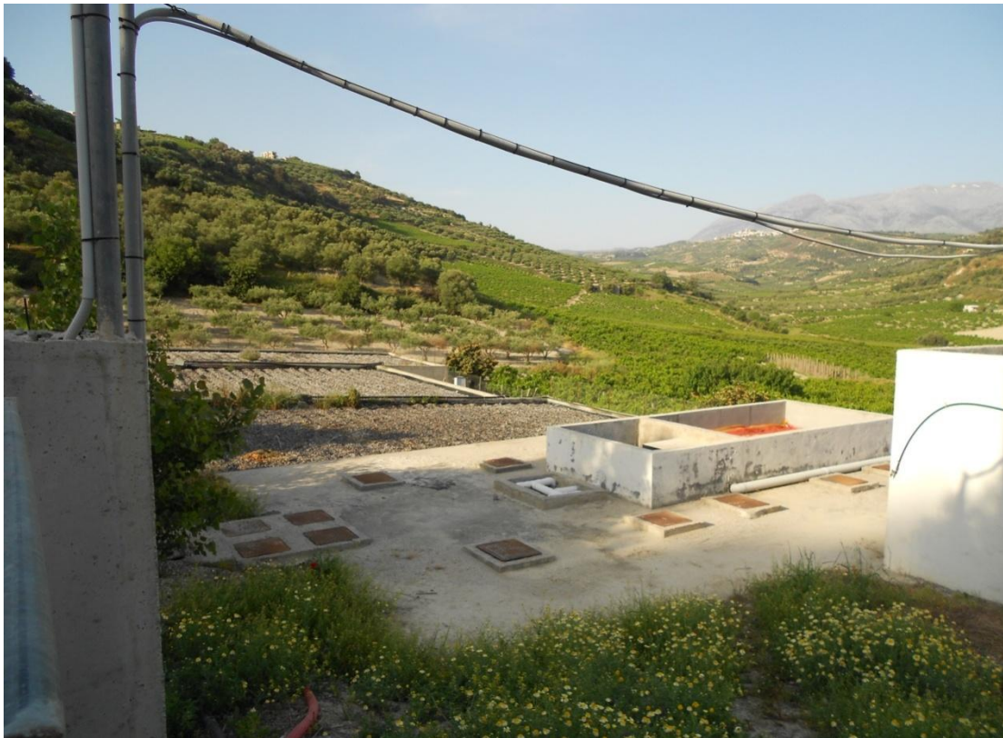
Εικόνα 2.1: Εγκατάσταση επεξεργασίας υγρών αποβλήτων Σταυρακίων - Βουτών.
