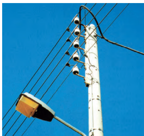
Εικόνα 2. Οι αγωγοί στα καλώδια της ΔΕΗ
